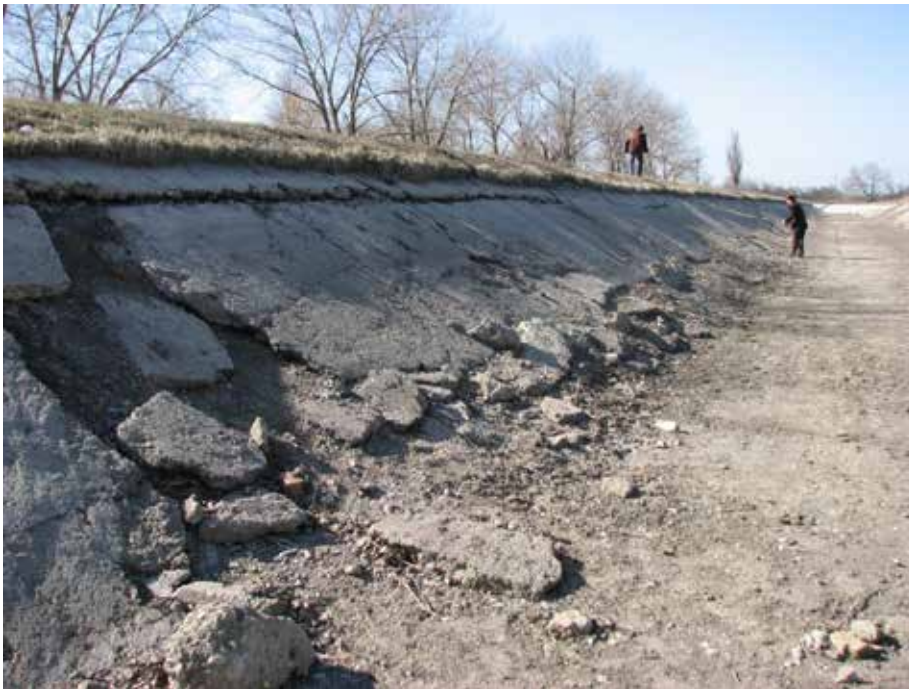
Рис. 1. Технічний стан бетонного облицювання Інгулецького магістрального каналу до виконання ремонтних робіт (фото Є. Козленка)
