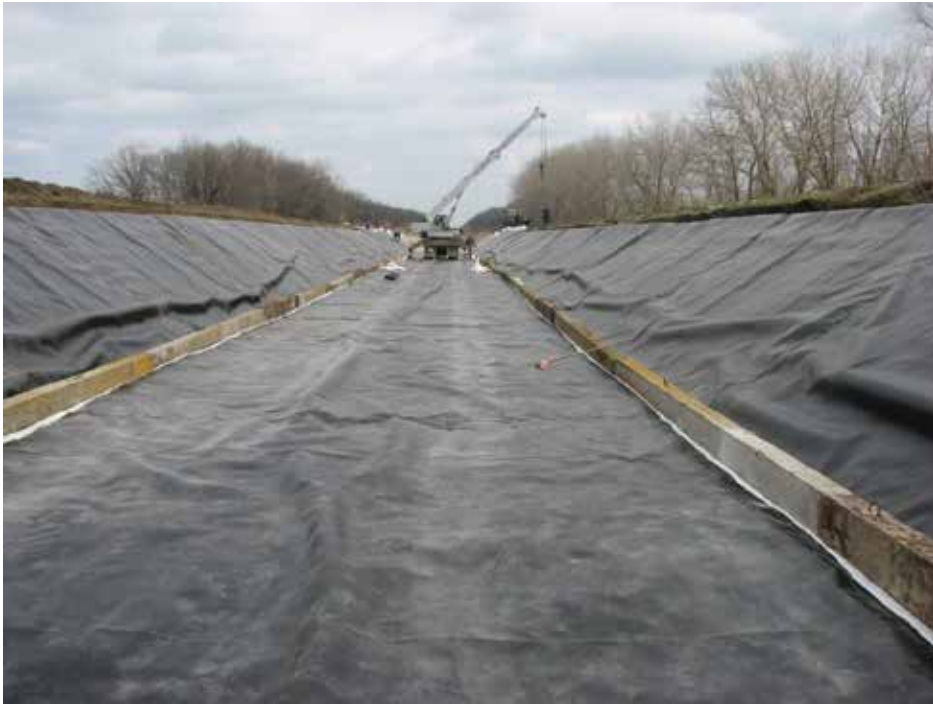
Рис. 2. Технічний стан Інгулецького магістрального каналу після виконання ремонтних робіт (укладання геомембрани) (фото Є. Козленка)
