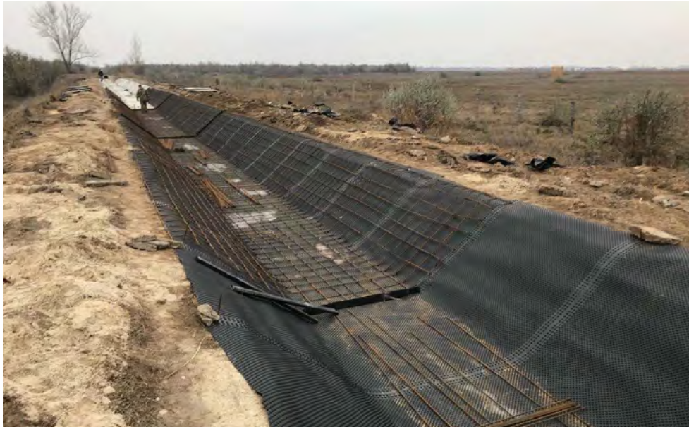
Рис. 2. Укладання шипоподібної мембрани Izolit та металевої арматури перед проведенням бетонних робіт на каналі P-4-2 Інгулецької зрошувальної системи
