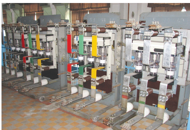
Рис. 2. Сучасні вакуумні вимикачі ВВ/TEL 10-20-630, що встановлені на Головній насосній станції Інгулецької зрошувальної системи
