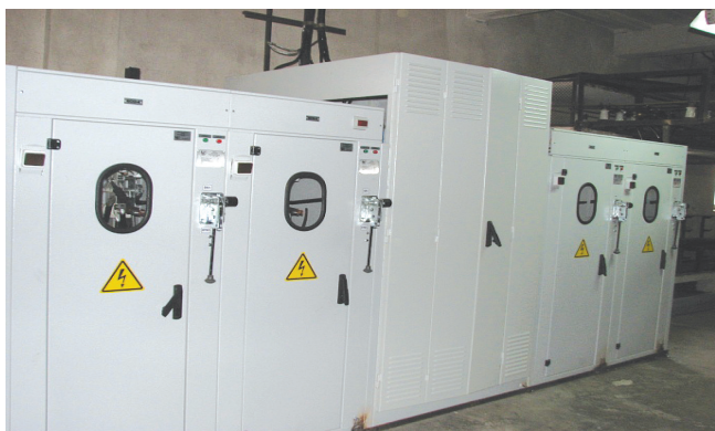
Рис. 1. Система плавного пуску електродвигунів Головної насосної станції Інгулецької зрошувальної системи
