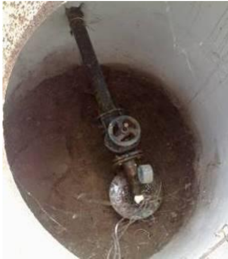
Рис. 2. Водозабір № 5-70 із підземного джерела з підземним павільйоном
