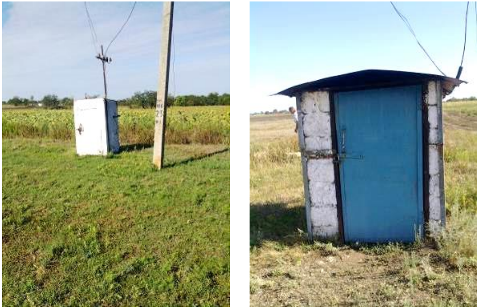
Рис. 4. Технічний стан споруди для розміщення щита управління роботою насосного обладнання водозаборів
