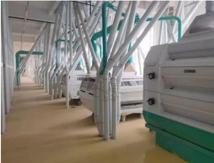
Рис. 4. Технологічне обладнання для виготовлення кукурудзяного борошна
